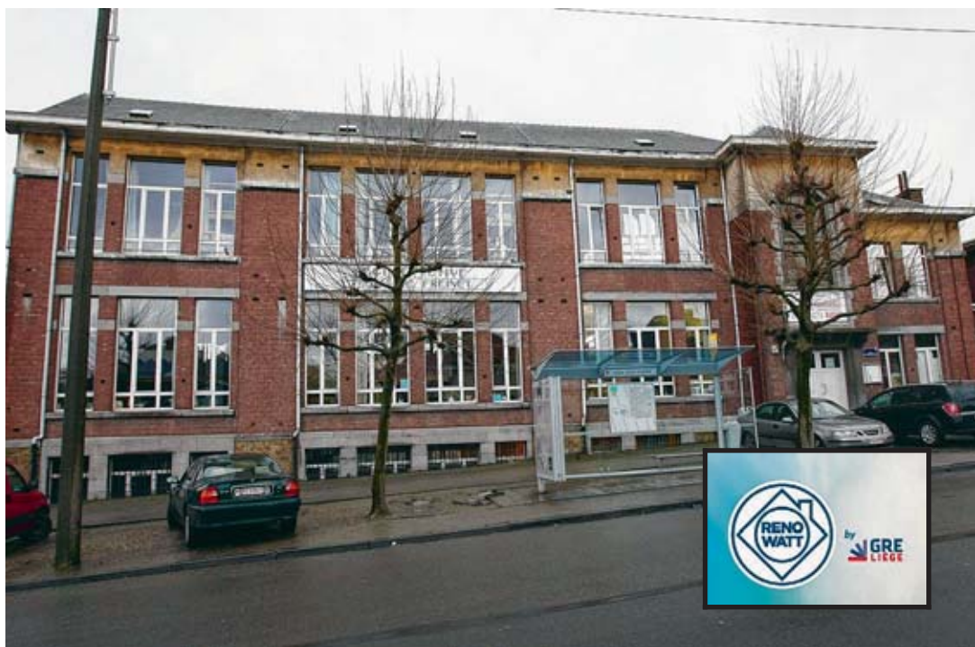
A Liège, l'école Naniot pourrait ainsi être rénovée pour consommer moins d'énergie. Le logo RenoWatt. ■ L.S.
